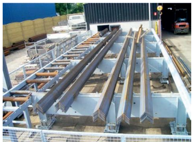
Транспортная система загрузки заготовок, находящаяся снаружи помещения на заводе металлоконструкций.
